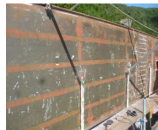
剥離後の残存塗膜
