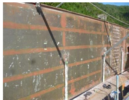
剥離後の残存塗膜
